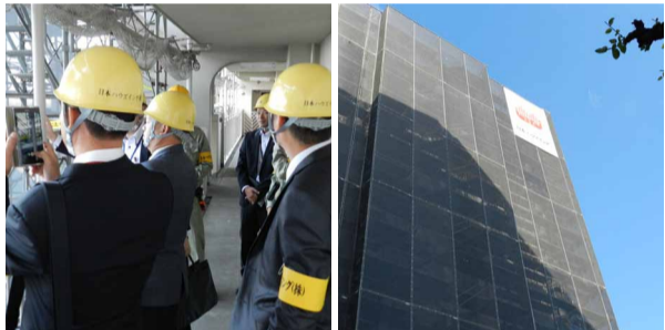
參訪長期修繕施工案場，外觀幾乎看不出來是維修整建工程
