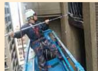
專業高空作業吊籠設備
