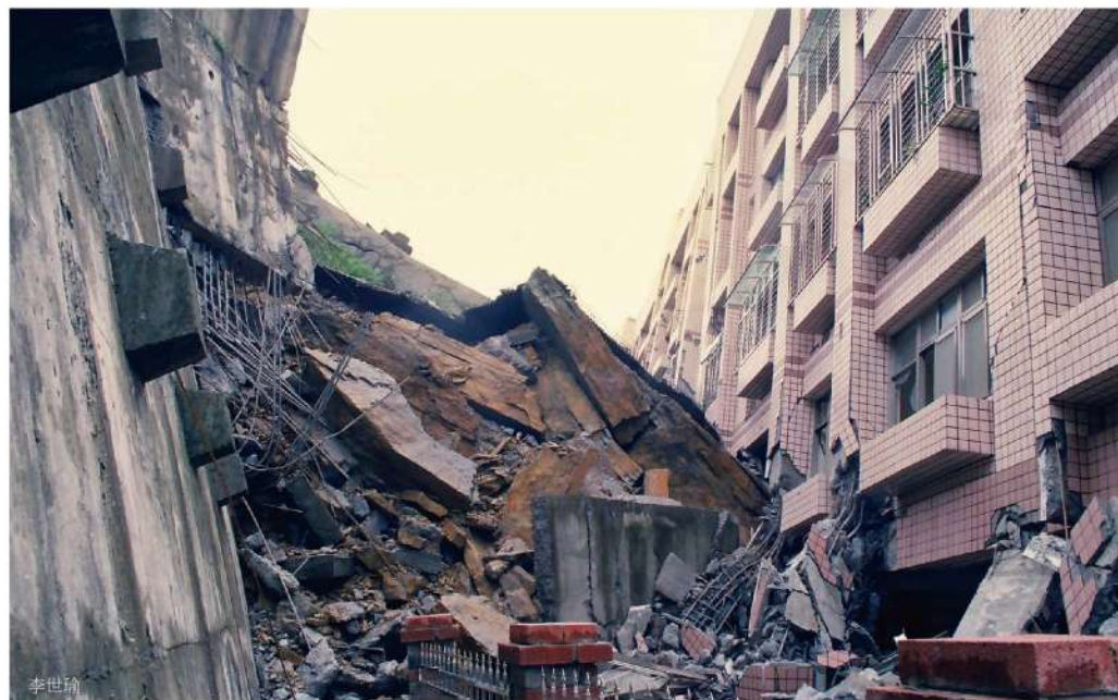
▲民國86年8月溫妮颱風造成林肯大郡擋土牆崩落，28人死亡，100多人房屋損毀無家可歸（資料來源：李世瑜）
